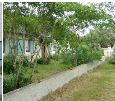
Muret en attente de rénovation avec couronnement à prévoir. Ancenis.
